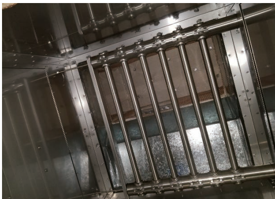
写真⑤ 空調機内 専用蒸気ノズル (PSオプティソープ)
