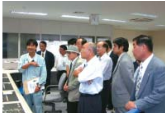
中央監視システム
