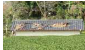
屋根瓦がめくれた住家
