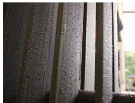
冷房時結露の様子
