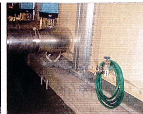
④ 貯水槽本体に直接蛇口を付け給水
